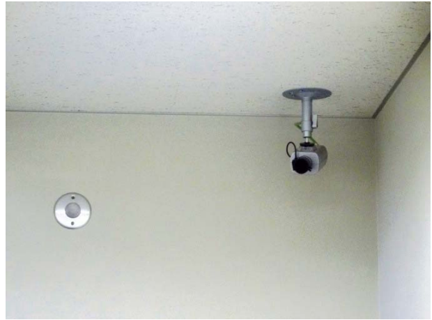
防犯カメラの設置 (2013.4)
